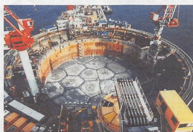
内核部水中不分離性コンクリート打設完了後(海面下10m)
